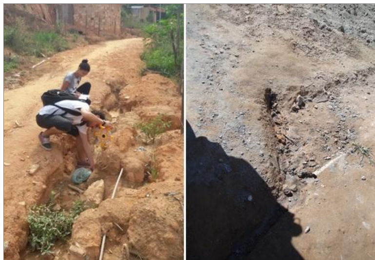
Figura 7 - Processos de erosão na Rua Bela provocados pelo escoamento de água pluvial e servida à esquerda e despejo de água servida na rua à direita
